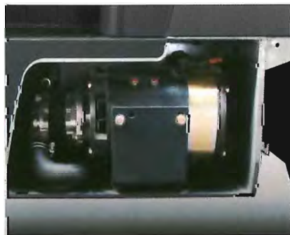
ポンプモーターとメインポンプ
